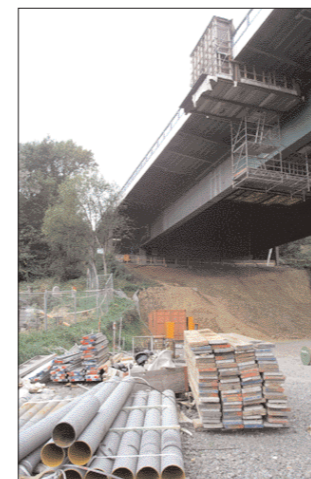
An der Absturzstelle lagert umfangreiches Baumaterial.
